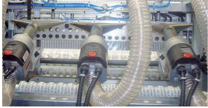
Drei LHS 61S Lufterhitzer mit Breitschlitzdüse in einer Packstrasse.
