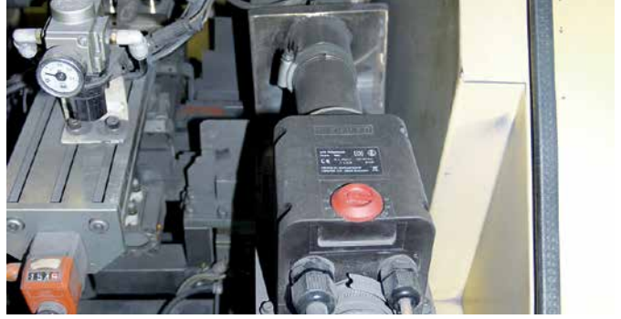
LHS加热器用于清除活性炭过滤器金属管
