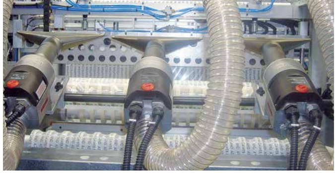
包装线上的3台带宽槽风嘴 LHS 61S 加热器
