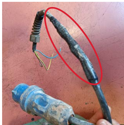
使用损坏的电缆。
