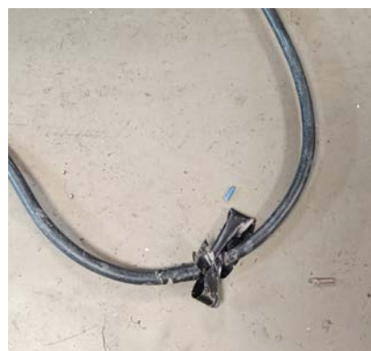
电缆 因使用不当造成的损坏, 例如将设备拉过边缘或反复弯曲电源连接线。
