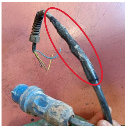
Použitie poškodeného kábla.
