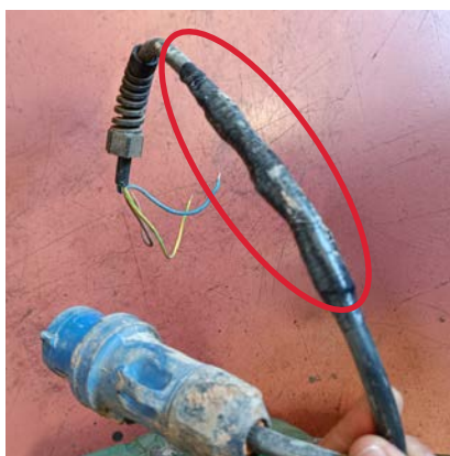
Использование повреждённого кабеля.
