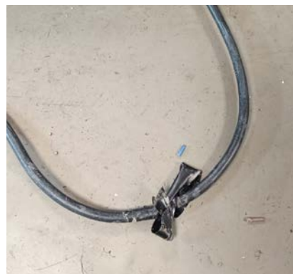
ケーブル エッジに引っ掛ける、主電源接続ケーブルを繰り返し折り曲げる等の不適切な使用による損傷。
