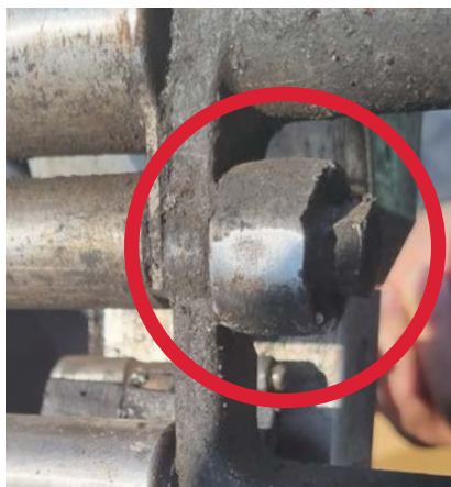
重度の汚れ 重度の汚れの蓄積により、ベアリングが詰まり、回転が妨げられる。
