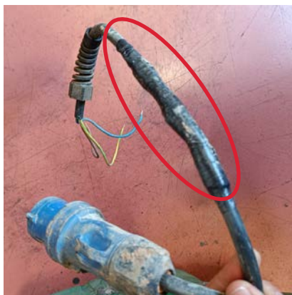
Utilisation d'un câble endommagé
