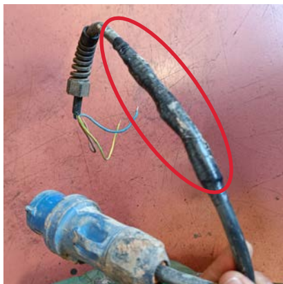
Uso de un cable dañado.
