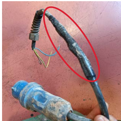
Verwendung eines beschädigten Kabels.
