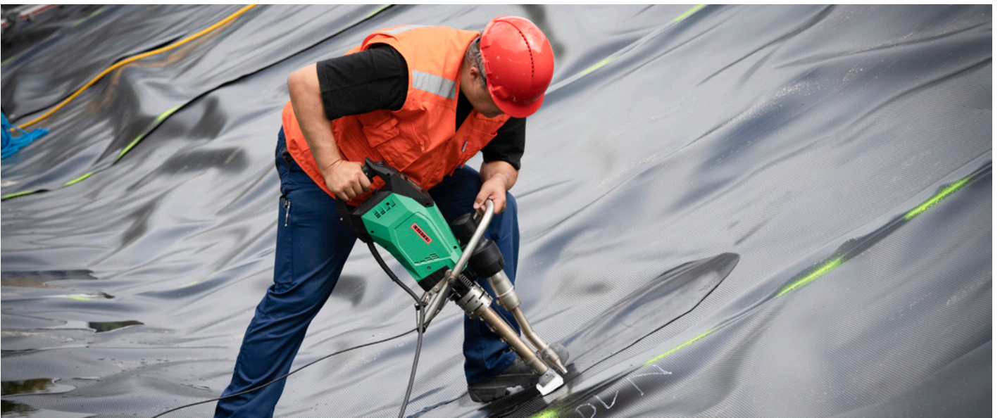
使用Leister WELDPLAST 605挤出焊枪在池塘中对HDPE膜材进行挤出式焊接
