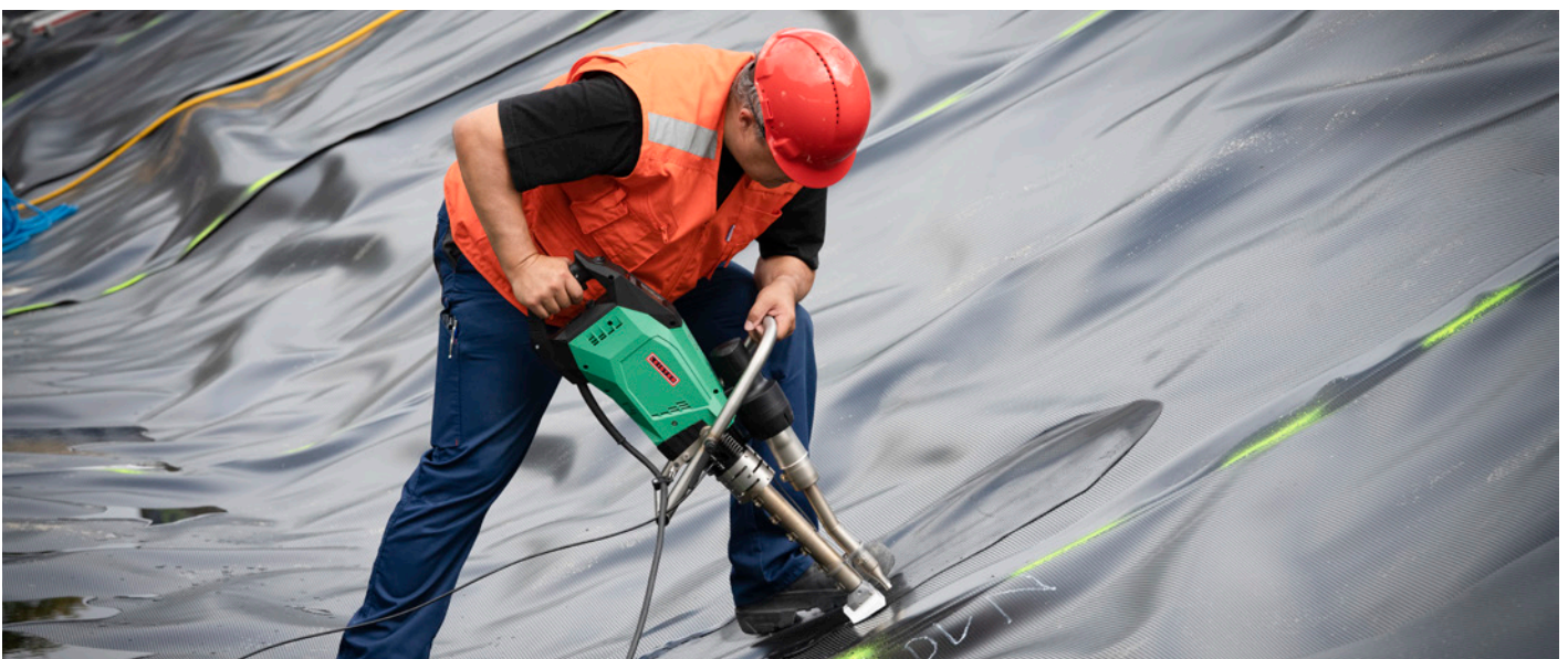
Extrusielassen van een HDPE-afdichtingsbaan met de Leister WELDPLAST 605 extruder in een vijver
